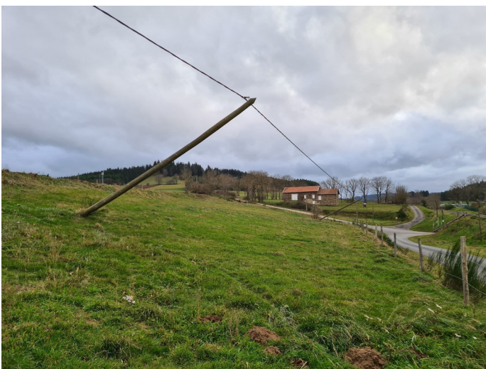
Poteaux menaçant de s'effondrer à Pouzols
